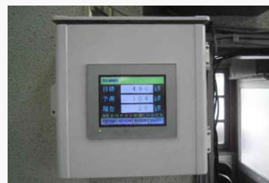
デマンド監視装置
