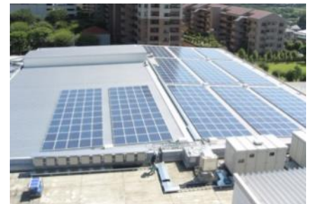
太陽光発電システム
