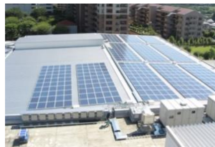
太陽光発電システム
