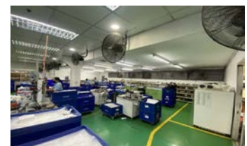
エアコンに替えて空冷式チラーを導入 (ジャノメタイランド(株))
