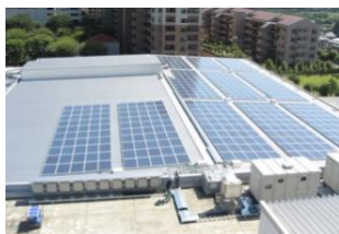
太陽光発電システム
